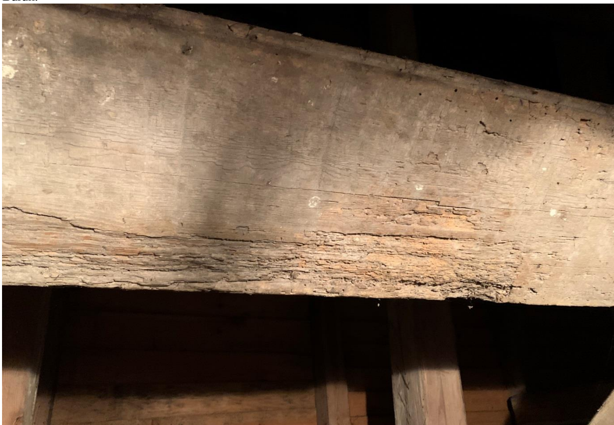
Fot.20. Stare Juchy- kościół znajdująca się przy ul. Elckiej 16 – więźba dachowa- stan obecny. Fot. M.Feiertag-Baran.
