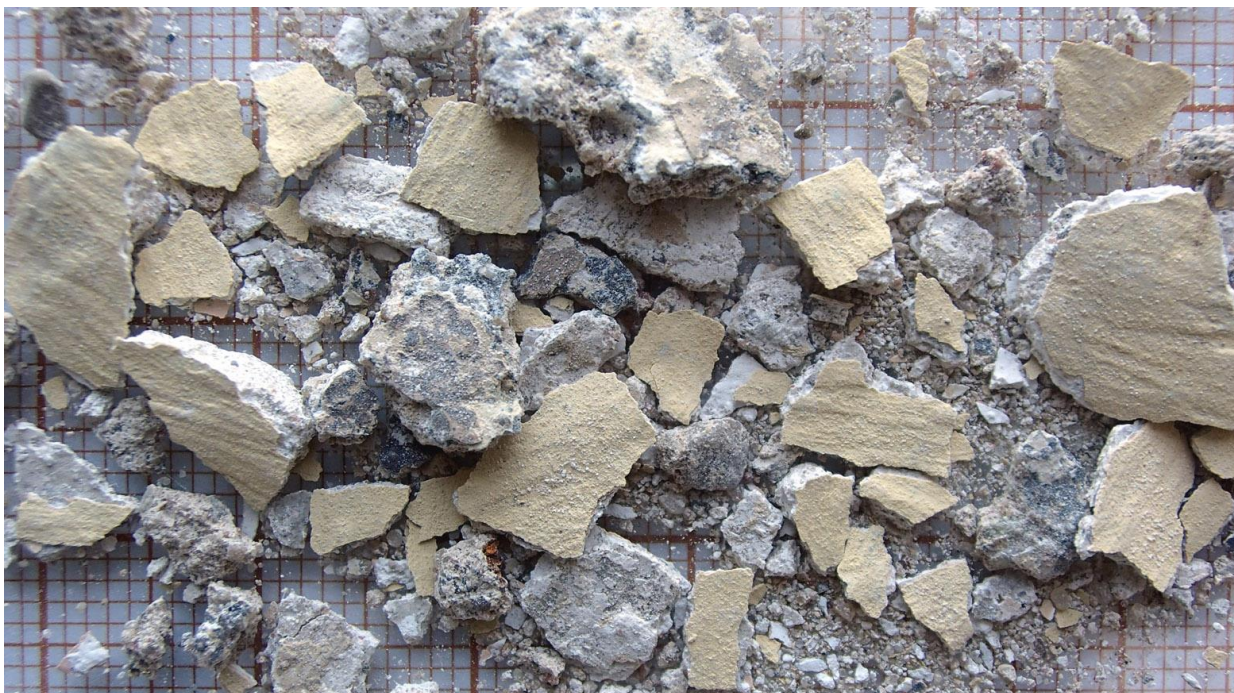
Fot. 1. Próbkę wyprawy tynkarskiej C1 poddana analizie zasolenia – widok od lica i od strony tynku.
