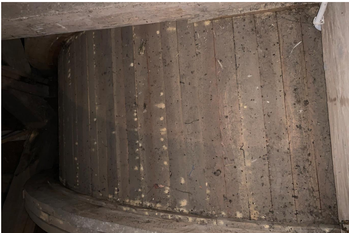
Fot.15. Stare Juchy- kościół znajdująca się przy ul. Elckiej 16 – więźba dachowa- stan obecny. Fot. M.Feiertag-Baran.
