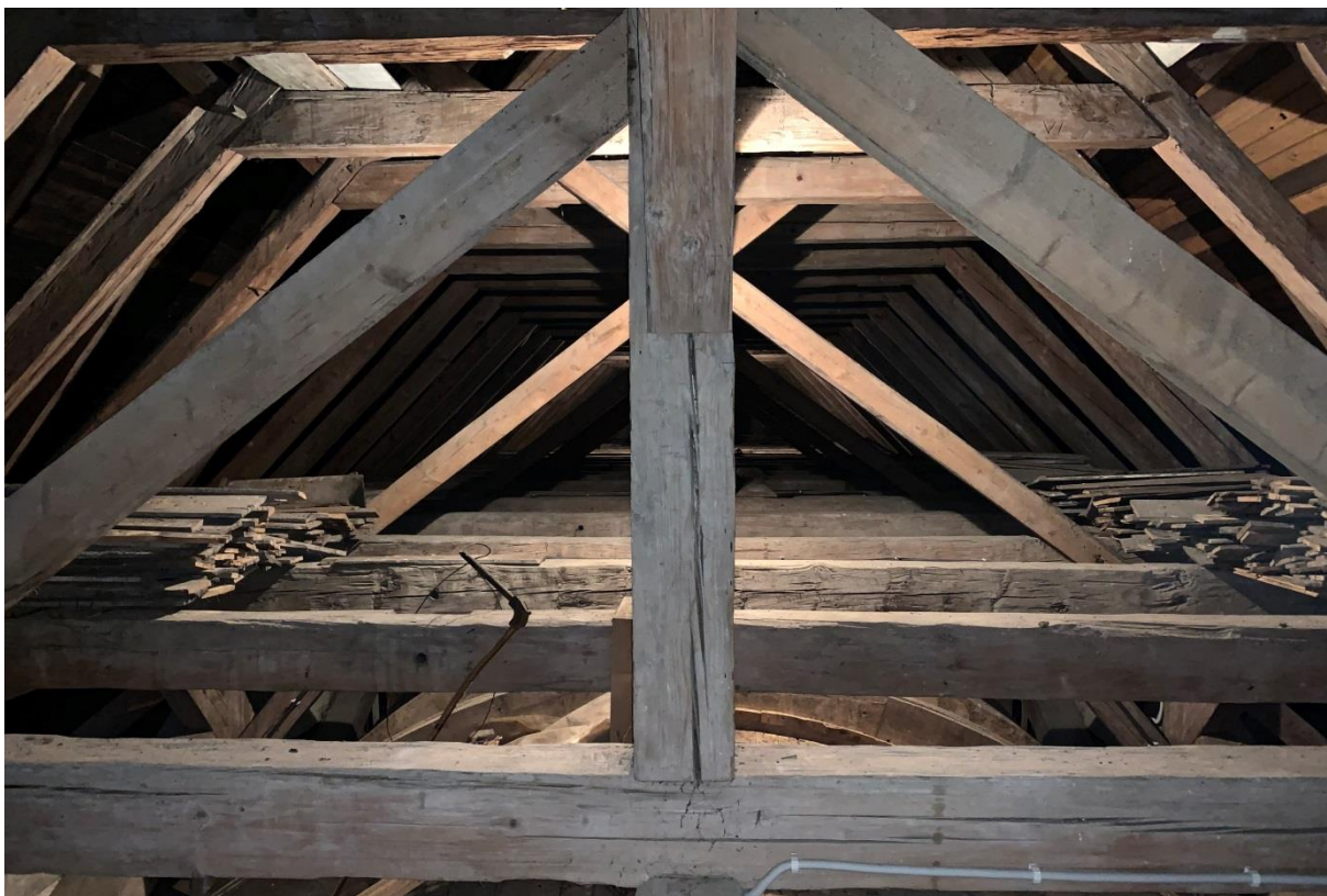
Fot.19. Stare Juchy- kościół znajdująca się przy ul. Elckiej 16 – więźba dachowa- stan obecny. Fot. M.Feiertag-Baran.
