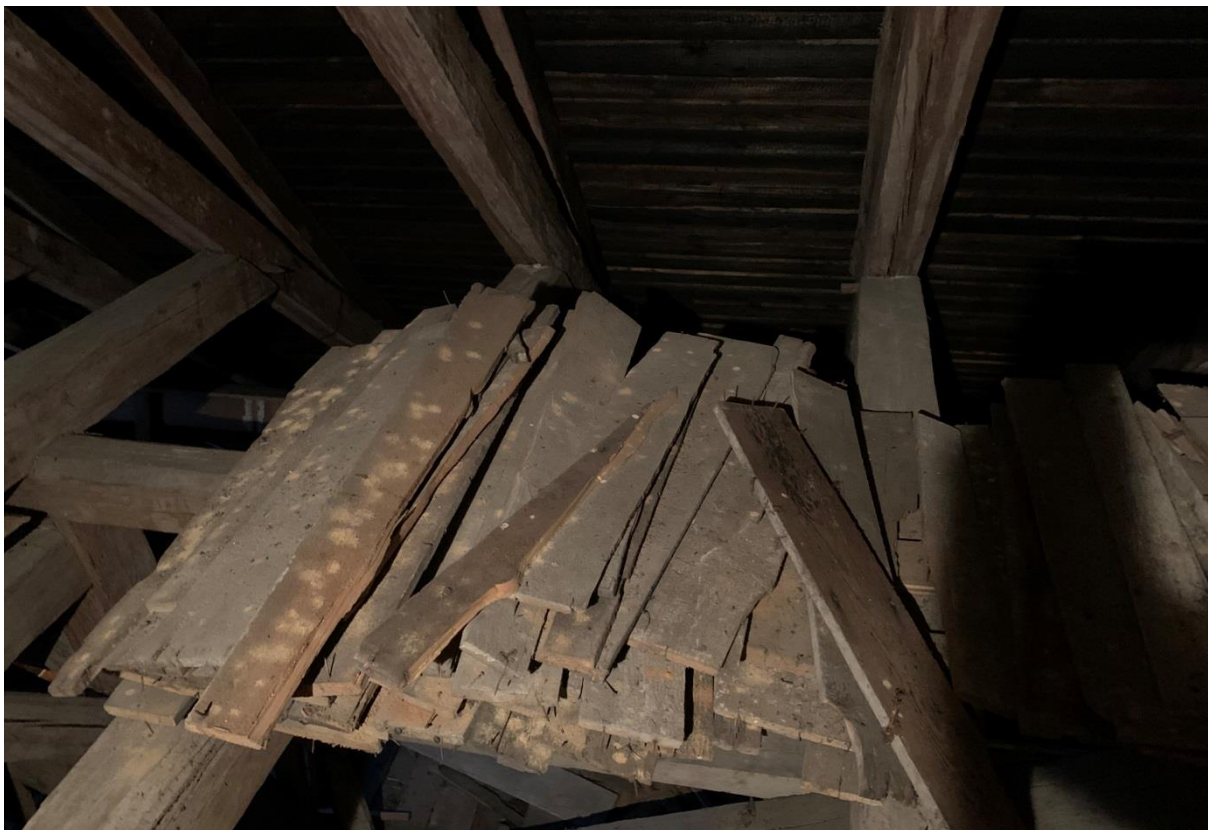
Fot.22. Stare Juchy- kościół znajdująca się przy ul. Elckiej 16 – więźba dachowa- stan obecny. Fot. M.Feiertag-Baran.
