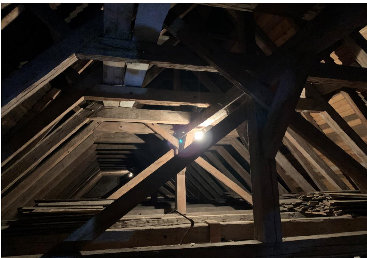
Fot.16. Stare Juchy- kościół znajdująca się przy ul. Elckiej 16 – więźba dachowa- stan obecny. Fot. M.Feiertag-Baran.
