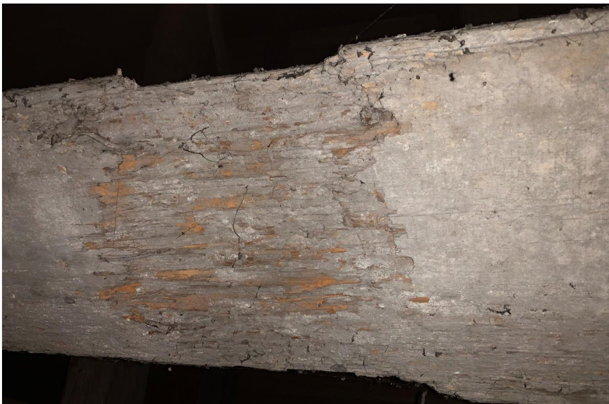
Fot.21. Stare Juchy- kościół znajdująca się przy ul. Elckiej 16 – więźba dachowa- stan obecny. Fot. M.Feiertag-Baran.
